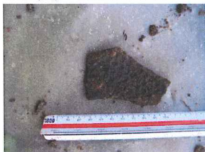
Fotonummer: 09 Omschrijving: Plaatje asbestverdacht materiaal (> 16 mm)
