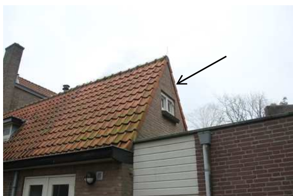
Potentiële verblijfplaats van de gewone dwergvleermuis; de ruimte tussen buitenmuur en gevelpan.
