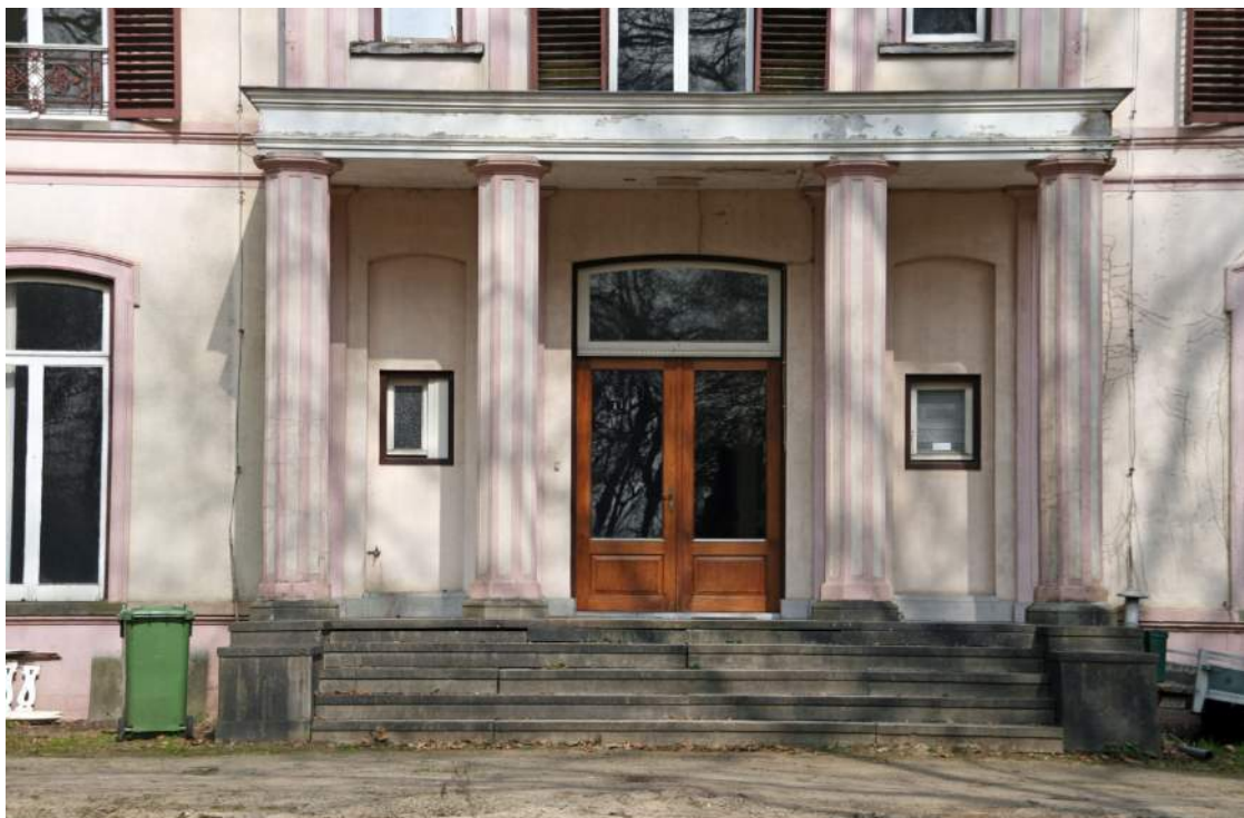
Afb. 21 De hoofdingang van het landhuis. De balkonbalustrade op de portiek is verdwenen.
