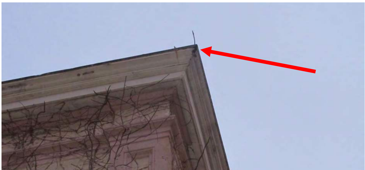
Verblijfplaats 3, van enkele tot minstens tien gewone dwergvleermuizen in verrotte hoek onder de zinken daktrim aan de zuidoostzijde van de villa
