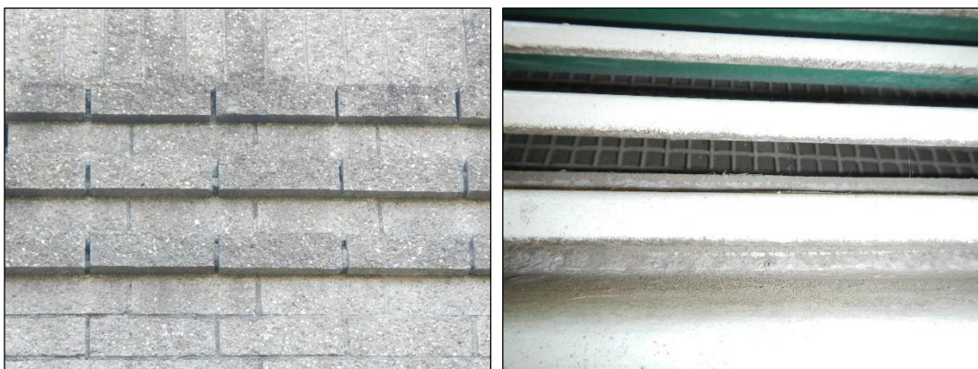
Figuur 5. Afgesloten gaten en roosters in de buitenmuur.
