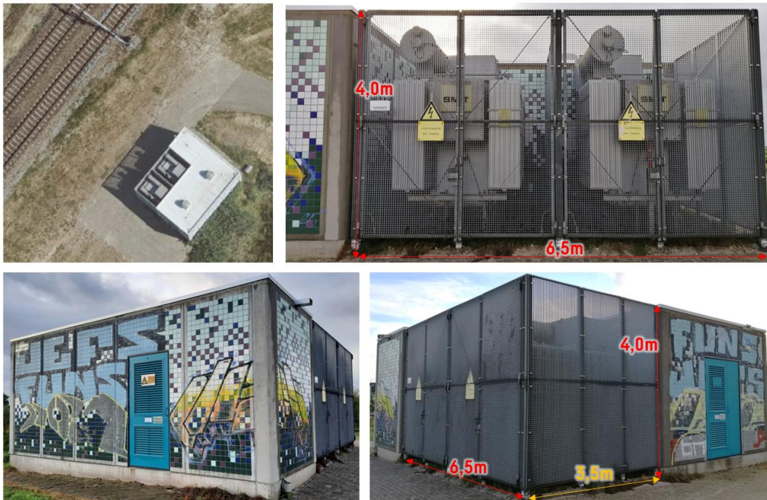
Figuur 3-2 Foto's bestaand onderstation Papekop. Linksonder: bovenaanzicht. Rechtsboven: vooraanzicht van de twee transformatoren. Links- en rechtsonder: zijaanzichten.
