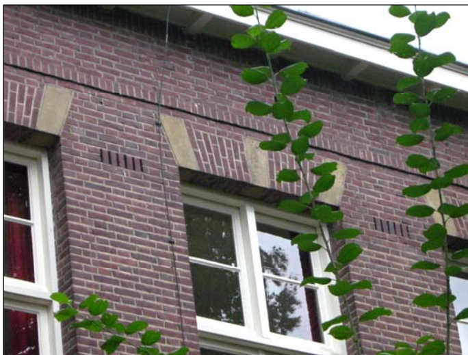
Afbeelding 3. Spouwontluchtings-spleten kunnen vleermuizen toegang bieden tot spouwruides. De spleten dienen tenminste 15 mm breed te zijn. Indien de spleten kleiner zijn dienen ze te worden vergroot. Soms zijn de ontluchtingspleten afgedekt met een (metalen) roostertje. Door dit te verwijderen kan een spouw toegankelijk worden gemaakt voor vleermuizen. Foto: auteur.
