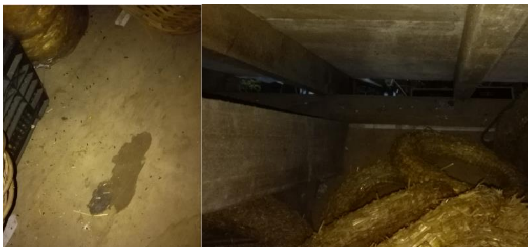
Figuur 3 Op de zolder van de schuur zijn uitwerpselen van vleermuizen (links) waargenomen. Het dakbeschoot van de schuur bestaat uit houten balken en planken. Tussen het dakbeschoot en de muur zijn ruimtes aanwezig waardoor vleermuizen de schuur kunnen betreden (rechts).
