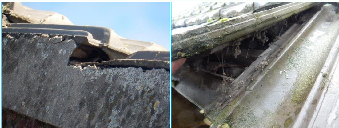
Foto's: Voorbeelden van openingen die bij nadere inspectie toch niet geschikt zijn gebleken en rechts het sporenonderzoek bij (gevel)pannen.
