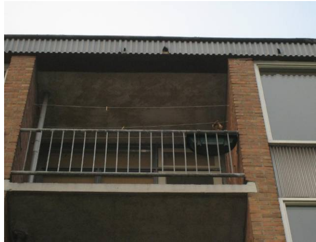
Foto 2: De dakrand van de flats bieden verblijfmogelijkheden voor vleermuizen
