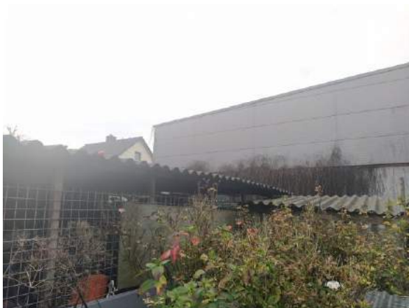
Foto 7: Twee opstallen met asbestverdachte dakbedekking zonder dakgoten
