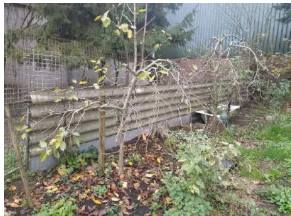
Foto 8: Erfafscheiding met (asbestverdachte) golfplaten
