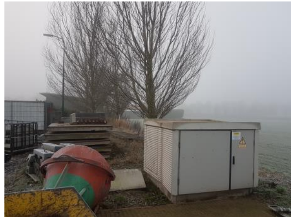
Foto 4: Gronddepot rondom trafohuisje
