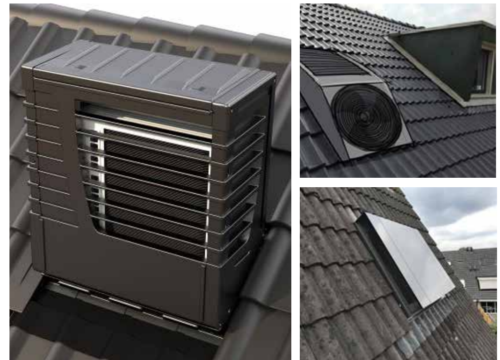
Buitenunits geïntegreerd in het bouwvolume
