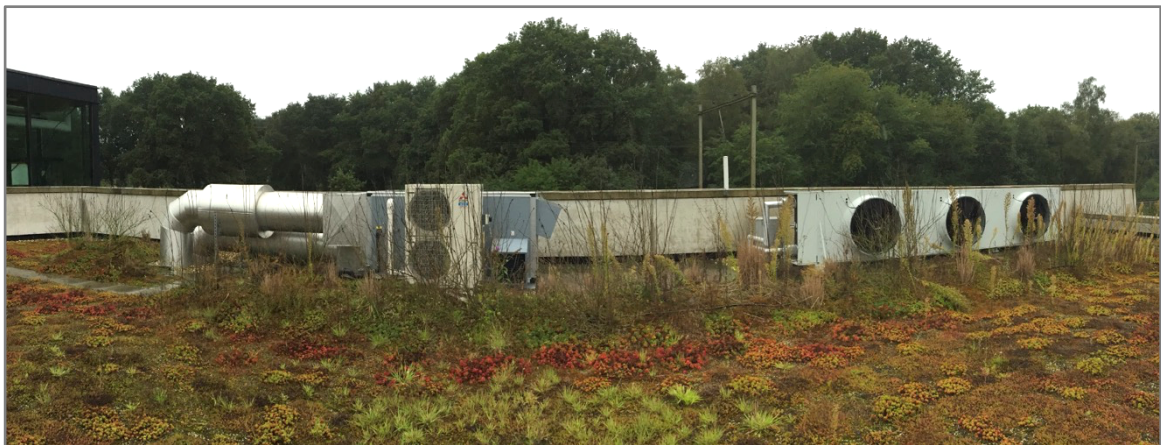
Figuur 2.4 Foto van de luchtbehandelingskasten op het dak
