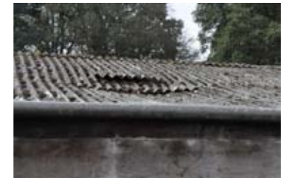
Slechte bouwkundige staat (asbest?)
