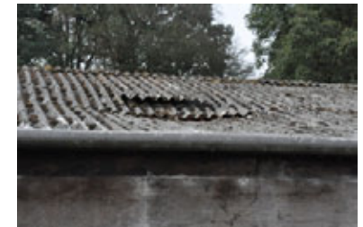
Slechte bouwkundige staat (asbest?)
