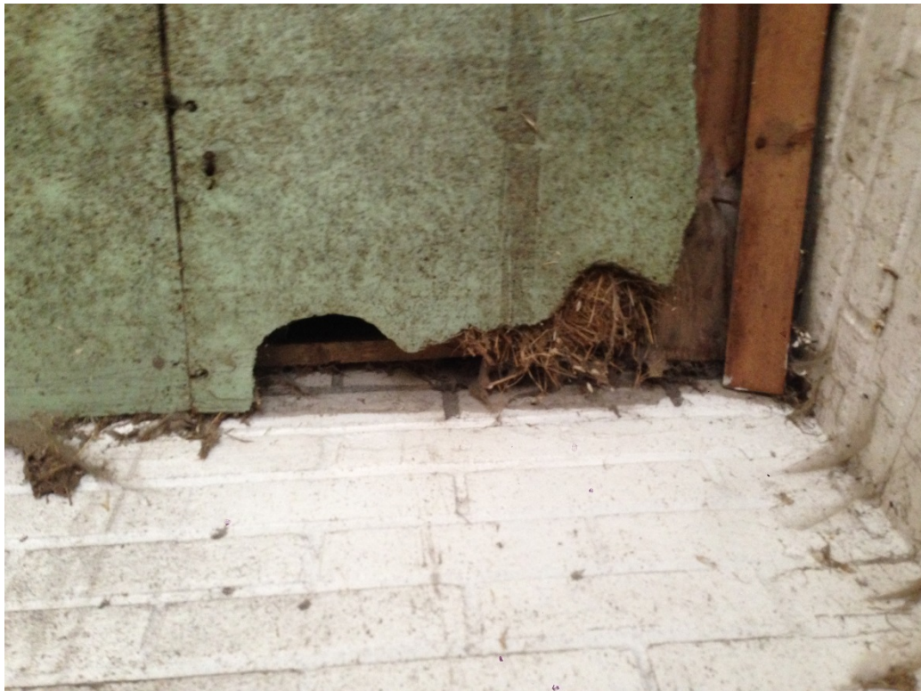
Figuur 3 Een open gedeelte met toegang tot de ruimte tussen het golfplaten dak en het isolatiemateriaal. Hier ook een huismussennest te zien gemaakt van stro en hooi uit de stallen.
