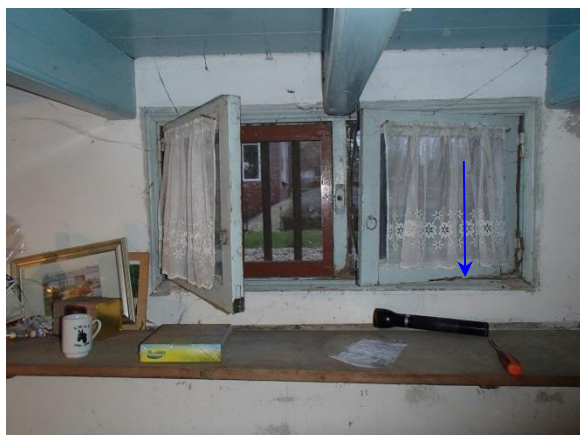
foto 1: kelder, ramen stopverf M01-asbestvrij
