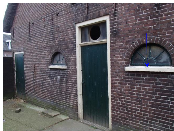
foto 4: stal, gevel, stalen ramen stopverf M03- asbestvrij
