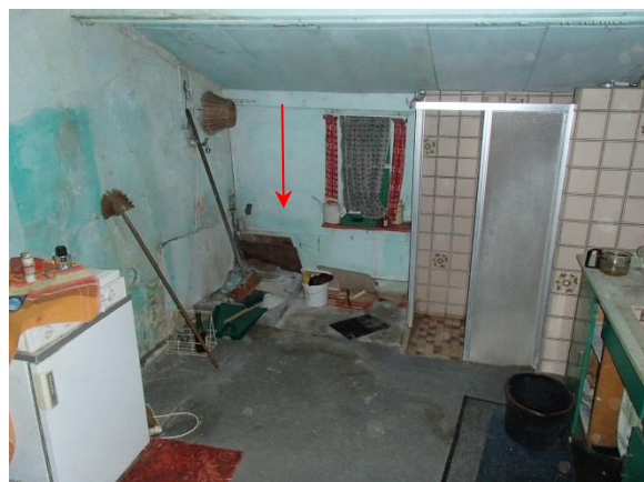
foto 3: boenhok, achterwand cementplaat M02- asbesthoudend
