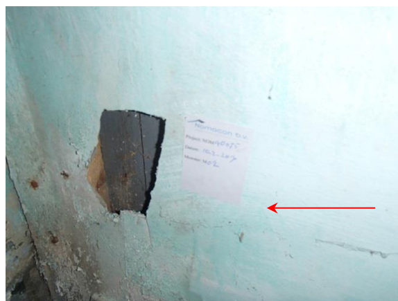
foto 2: boenhok, achterwand cementplaat M02- asbesthoudend
