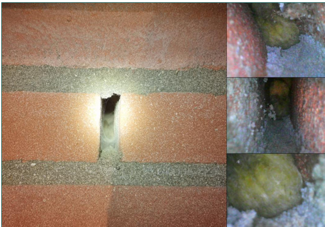
Figuur 3.1 Uitgebreide inspectie van de open stootvoegen bevestigde dat er geen sprake is van ruimte tussen gevel en isolatiemateriaal.
