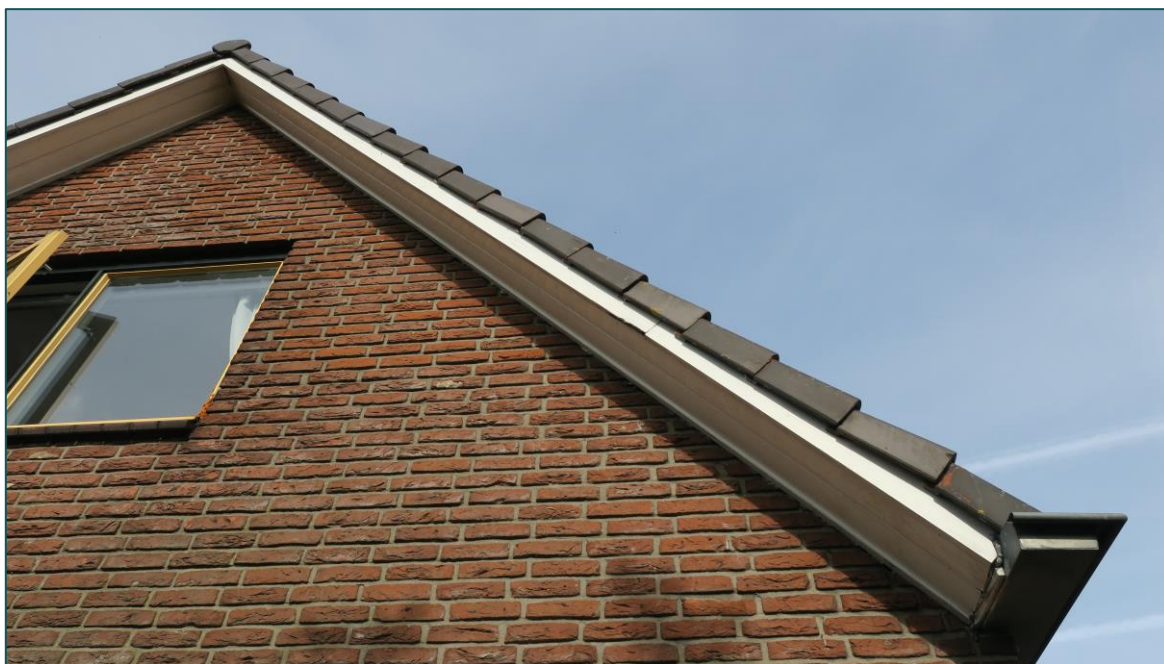
Figuur 3.3 De kantpannen van de woning en garage kieren voldoende om als invliegopening voor gierzwaluwen te dienen.
