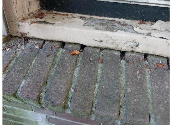
Open voegen vensterbank nummer 84
