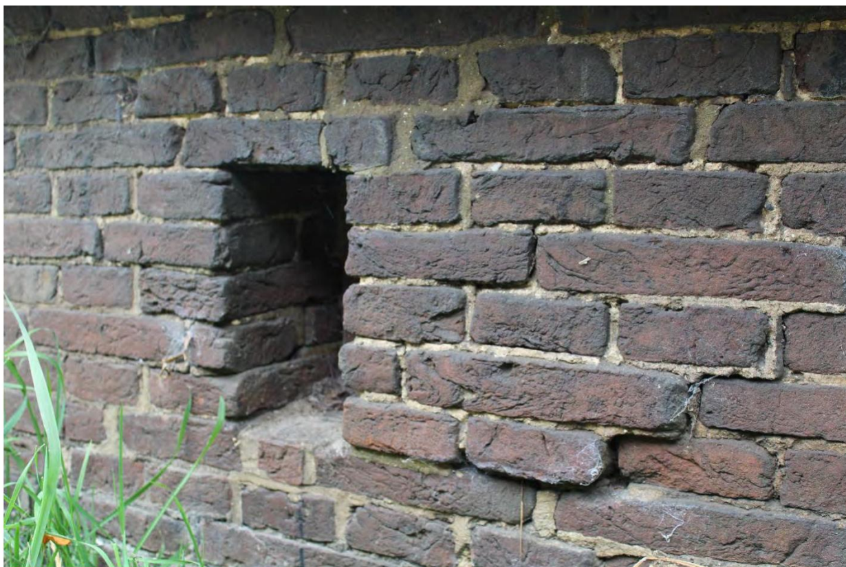
4 Scheurend en tandend metselwerk
