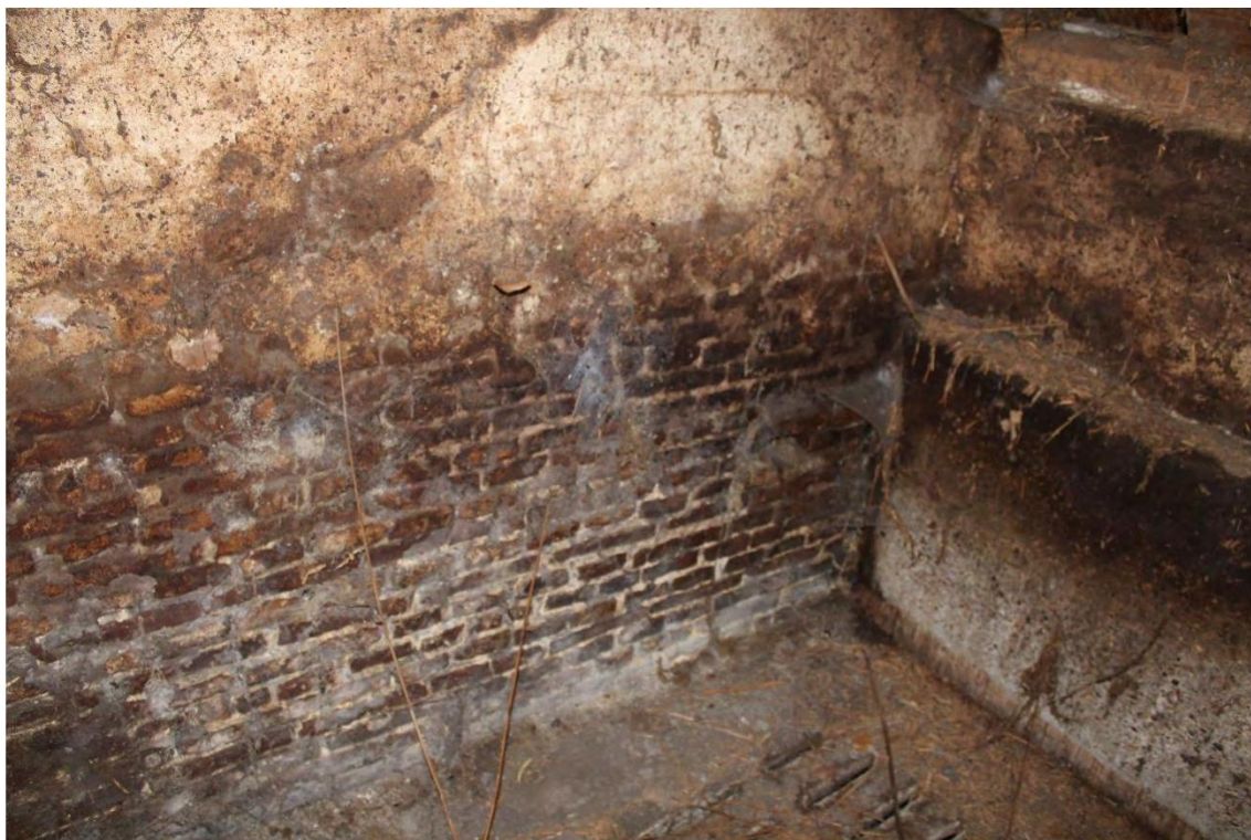
21 Zware vervuiling metselwerk met zichtbaar het mestkelderrooster en later aangebrachte voorzetwand zijgevel
