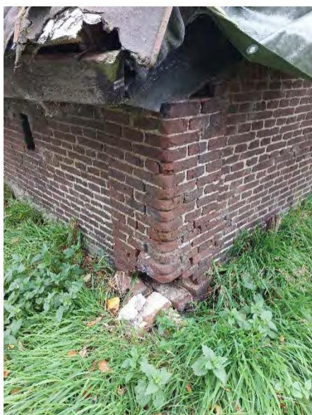
5 Diverse (mechanische) schades aanwezig
