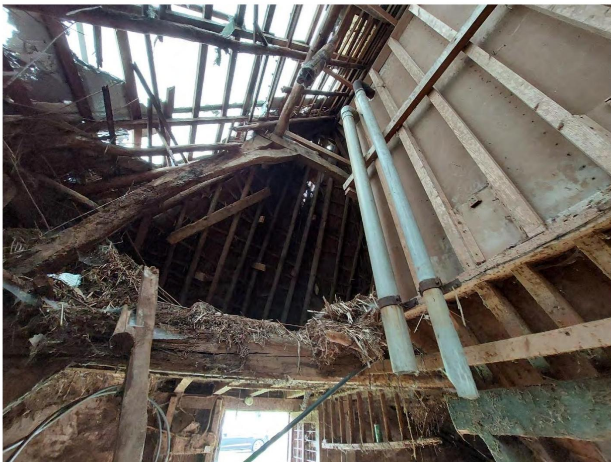
20 Rechts voersilo, ontbrekende onderdelen met zicht op zuid
