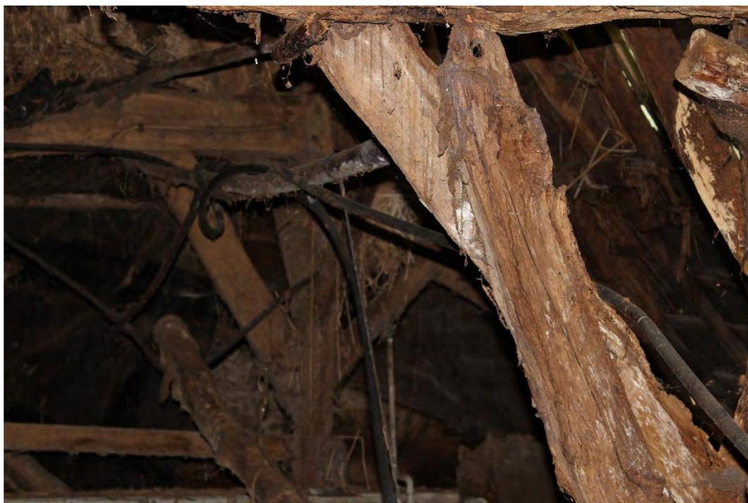
17 Detailopname uit elkaar vallende verbindingen
