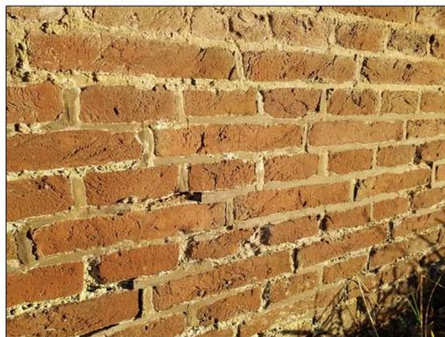
Detail voegwerk, foutief hersteld
