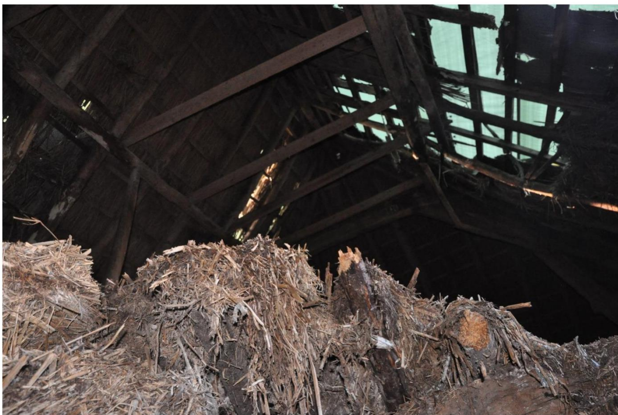
Figuur 2. Situatie in de schaapskooi (zolder) met dekzeil over het dak.
