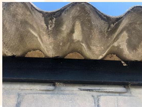
3.f Afwerking dakpannen, opening < 1cm
