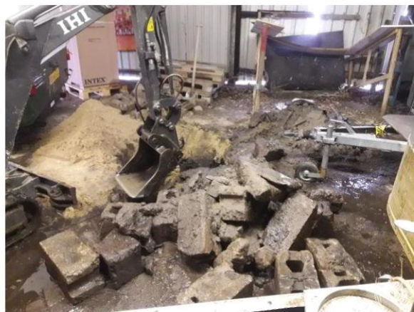
Foto 4: Inpandig ontgraven deel met puin/betonbrokken
