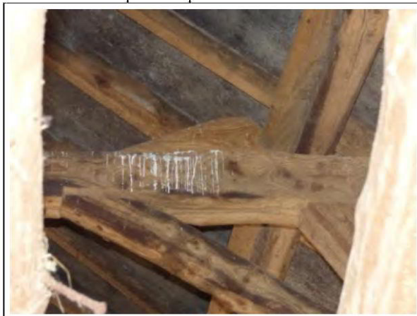
Foto 16 uitwerpselen op dwarsbalk schuur
