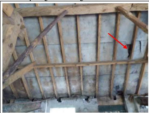
Foto 11 opening in beschadigd dakbeschot
