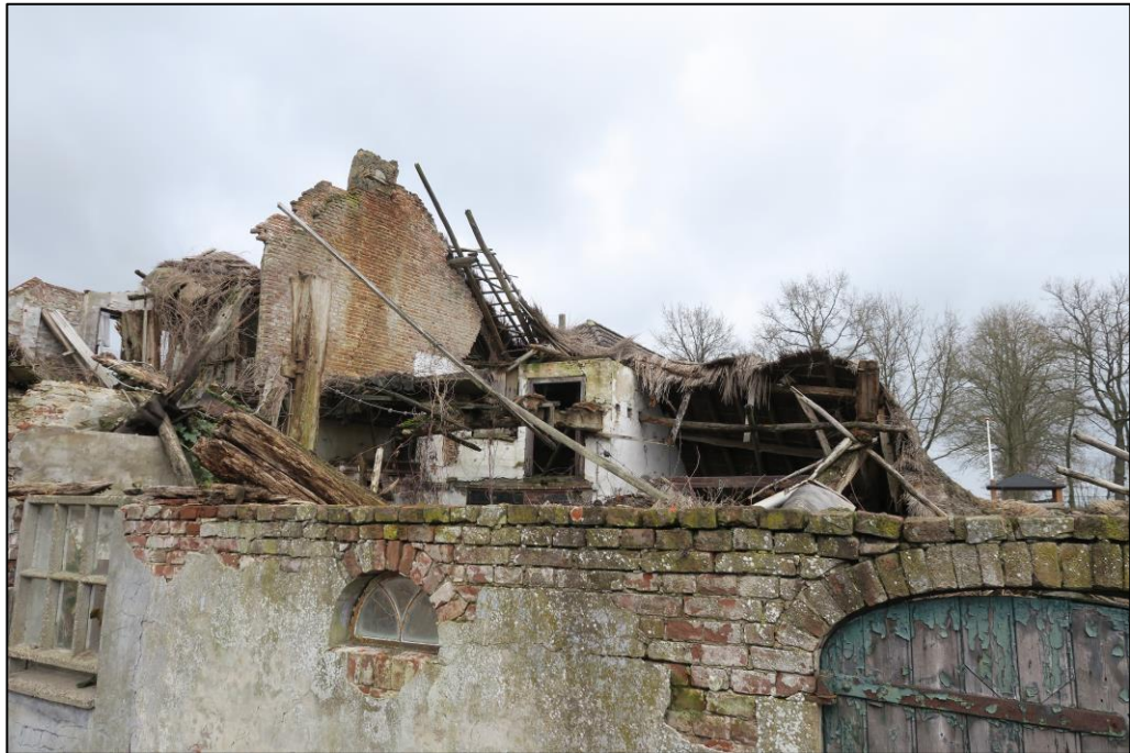
Figuur 3 De te saneren boerderij (gebouw C). Van dit gebouw is het dak vrijwel helemaal ingestort.
