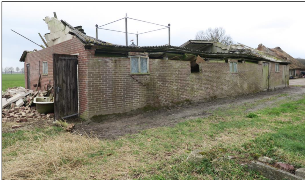
Figuur 4 Gebouw C (boerderij) verkeert in een erbarmelijk staat. Het dak is deels ingestort. Het zal aannemelijk niet lang duren voordat het hele gebouw is ingestort. In dit betreffende gebouw zijn braakballen van kerkuil waargenomen.
