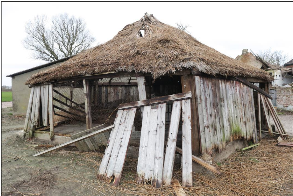
Figuur 6 Een van de schuren. Deze is tevens deels ingestort.
