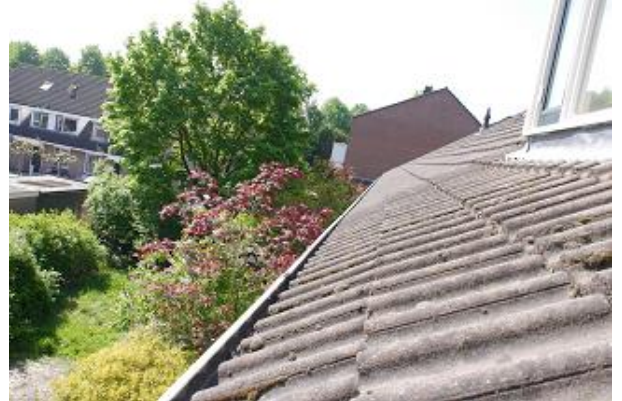
Foto 10: pannendak z.o-zijde gezien vanuit dakkapel. (foto Botani-Specialist)
