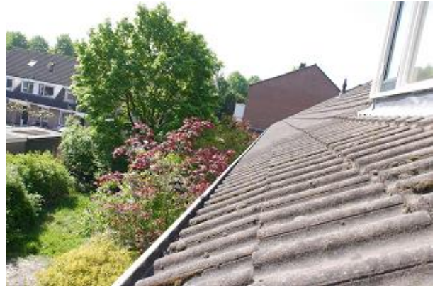
Foto 9: pannendak z.o-zijde gezien vanuit dakkapel. (foto Botani-Specialist)
