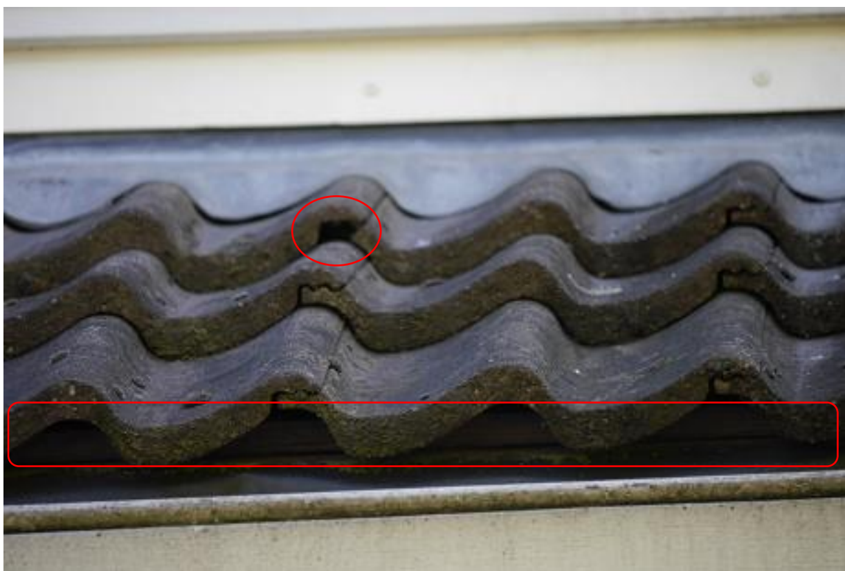
Foto 16: Aansluiting dakgoot en onderste rij dakpannen met mogelijk invliegopeningen / nestlocatie voor huismussen of vleermuizen. (foto Botani-Specialist)
