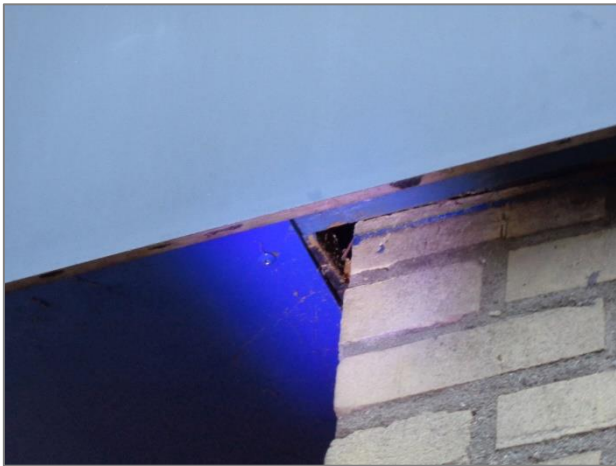
Afbeelding 3.1 | Holte tussen de betimmering en de muur (het Kompas)
