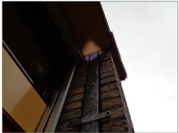
Afbeelding 3.3 | Goot die in een groef van de muur naar boven toe loopt
