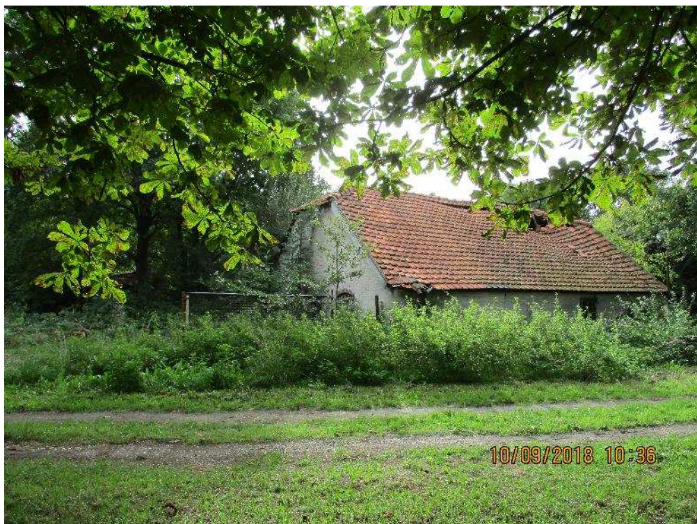
Figuur 4 De schuren liggen tussen de bomen in waar tevens struweel is gelegen. De schuren zijn zeer vervalLEN en de daken zijn gedeeltelijk ingestort.
