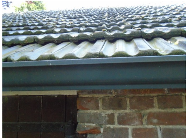
Gewoon muisjesmos op dakpannen noordzijde
