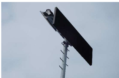
Afbeelding – Afscherming van de lichtarmaturen
