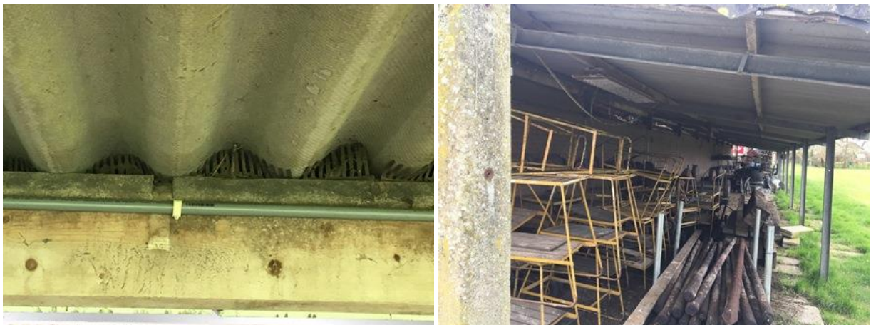
Foto links: vogelschroot onder de golfplaten; dit weerhoudt vogels om een nestplaats te bezetten onder de golfplaten. Foto rechts: opgeslagen spullen onder de overkapping; dit is een potentiële nestplaats voor verschillende vogelsoorten.
