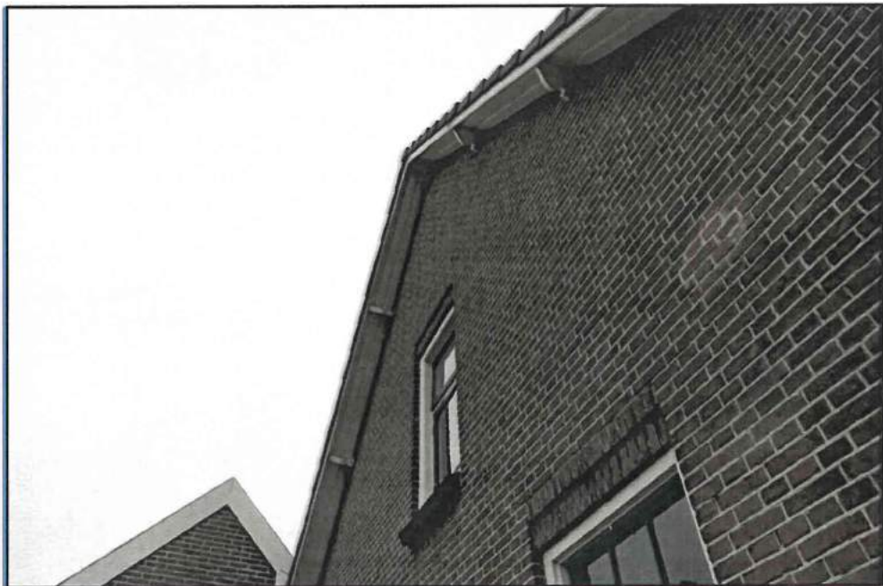
Figuur 2 De kant- en nokpannen op de planlocatie sluiten allen strak aan waardoor geen ruimte aanwezig is die door een gierzwaluw gebruikt kan worden als invliegopening.
