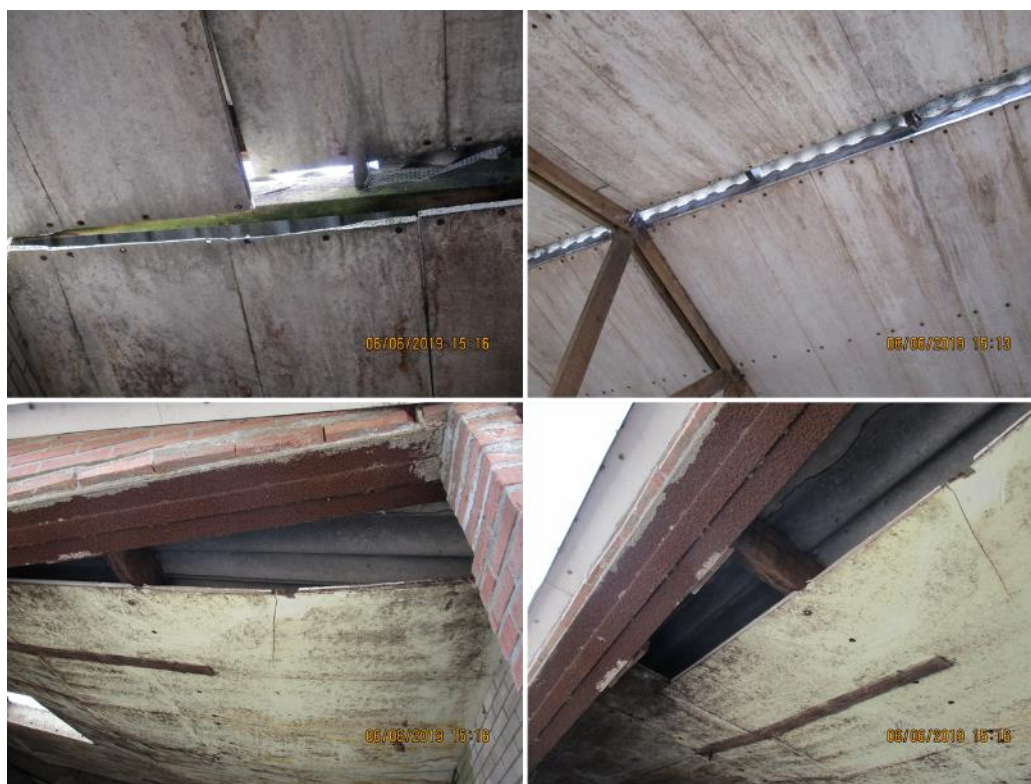
Figuur 4 In de schuur waar rijwielen staan opgeslagen is tussen het golfplaten dak en de houten platen aan de binnenzijde veel ruimte aanwezig. Een deel van de platen is erg doorgebogen. Aan de bovenzijde zijn de openingen tussen de houten platen en de golfplaten afgesloten.
