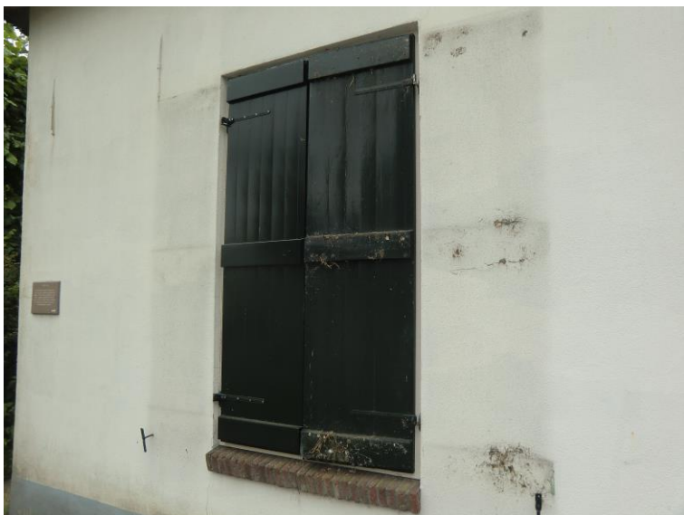
De nagmaakte luiken sluiten niet in de luikspinningen en sluiten ook niet goed tegen elkaar. Zij zijn aangebracht om het historische beeld te behouden.
