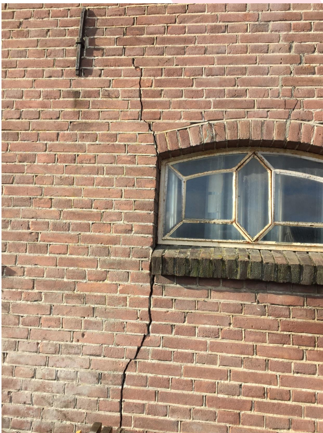
Stalraam oostgevel met ernstige scheurvorming
