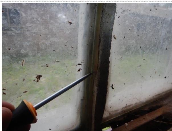
Siliconenkit in betonkozijnen deel
