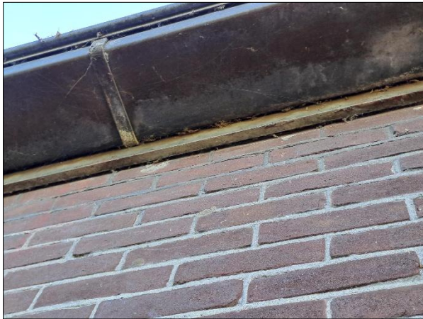
Foto: kier achter betimmering dakoverstek.
