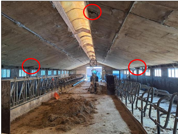
foto: Ligboxenstal; de rode cirkels geven gaten in de dakisolatie weer.
