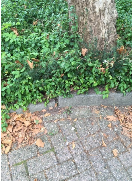
Afbeelding 8: Opdrukken straatstenen (Boom ID: AH09)
