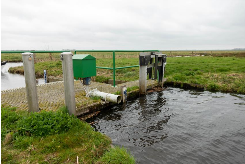
Figuur 9: Opvoerpomp en stuw Vaartweg
