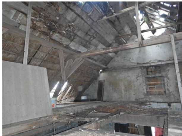
Dak deels ingestort, vloer deels niet meer aanwezig
