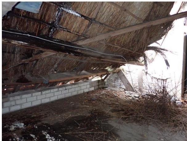
Dak deels ingestort
