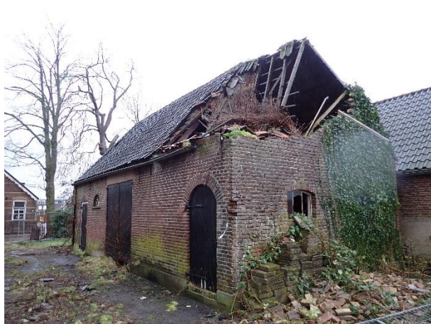
Dak deels ingestort
