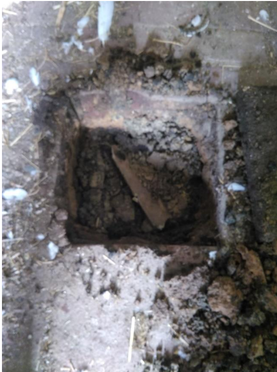
Foto 3: Gat 1001 inpandig, stortlaag aanwezig
