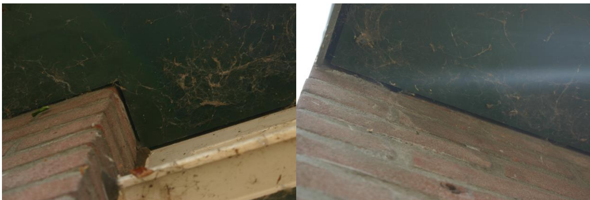
Figuur 4.4.3. De dakgootbetimmering kiert met de gevel.
