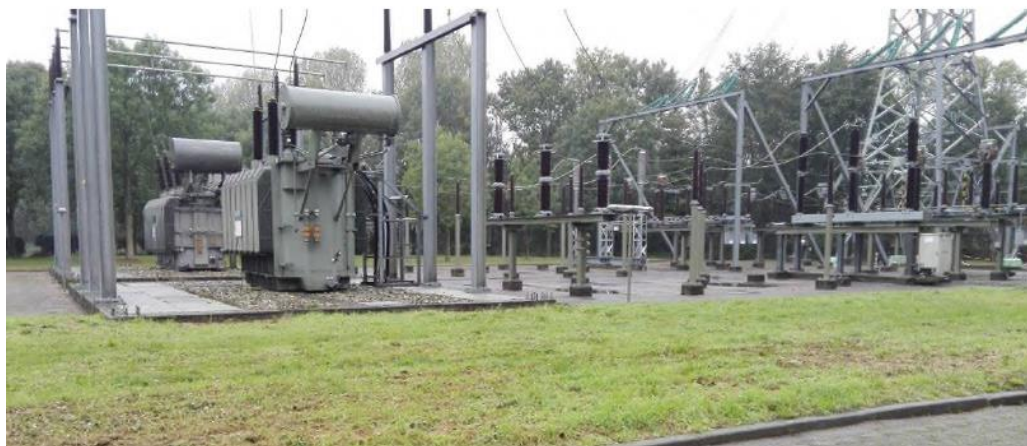
Figuur 2-4: Aanzicht installaties op het terrein
