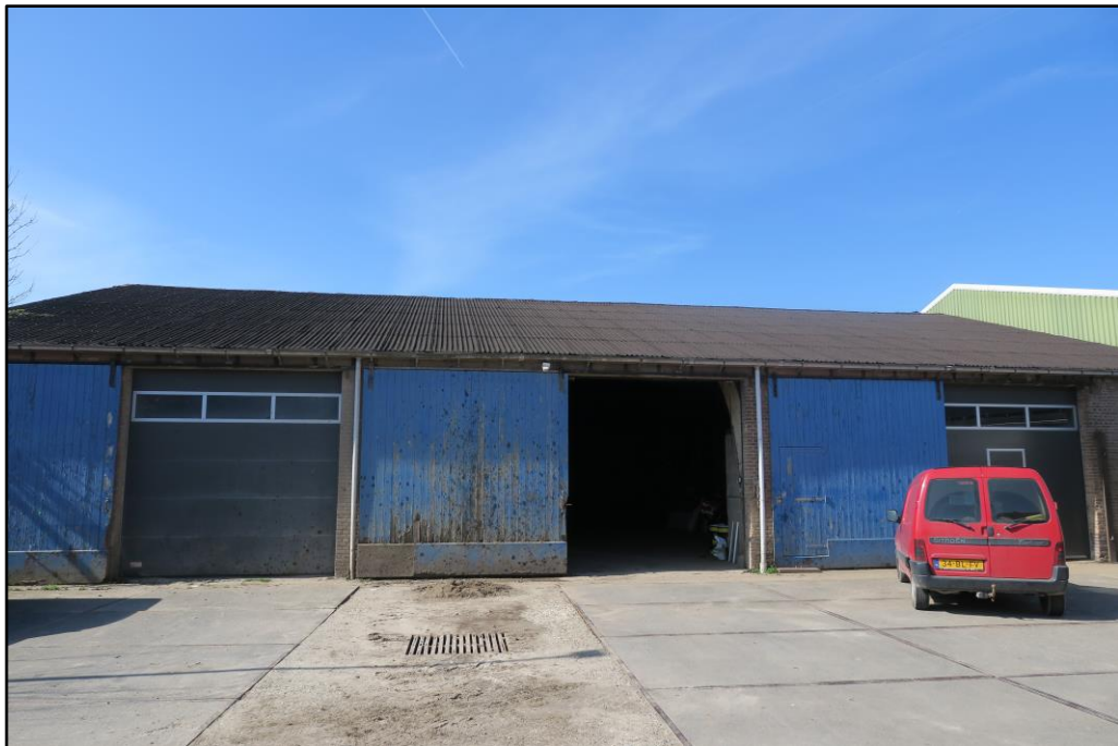
Figuur 2 Gebouw B, een loods bestaande uit gemetselde muren en een golfplaten dak.
