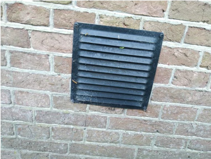
Foto 2: detail te verwijderen ventilatierooster.
