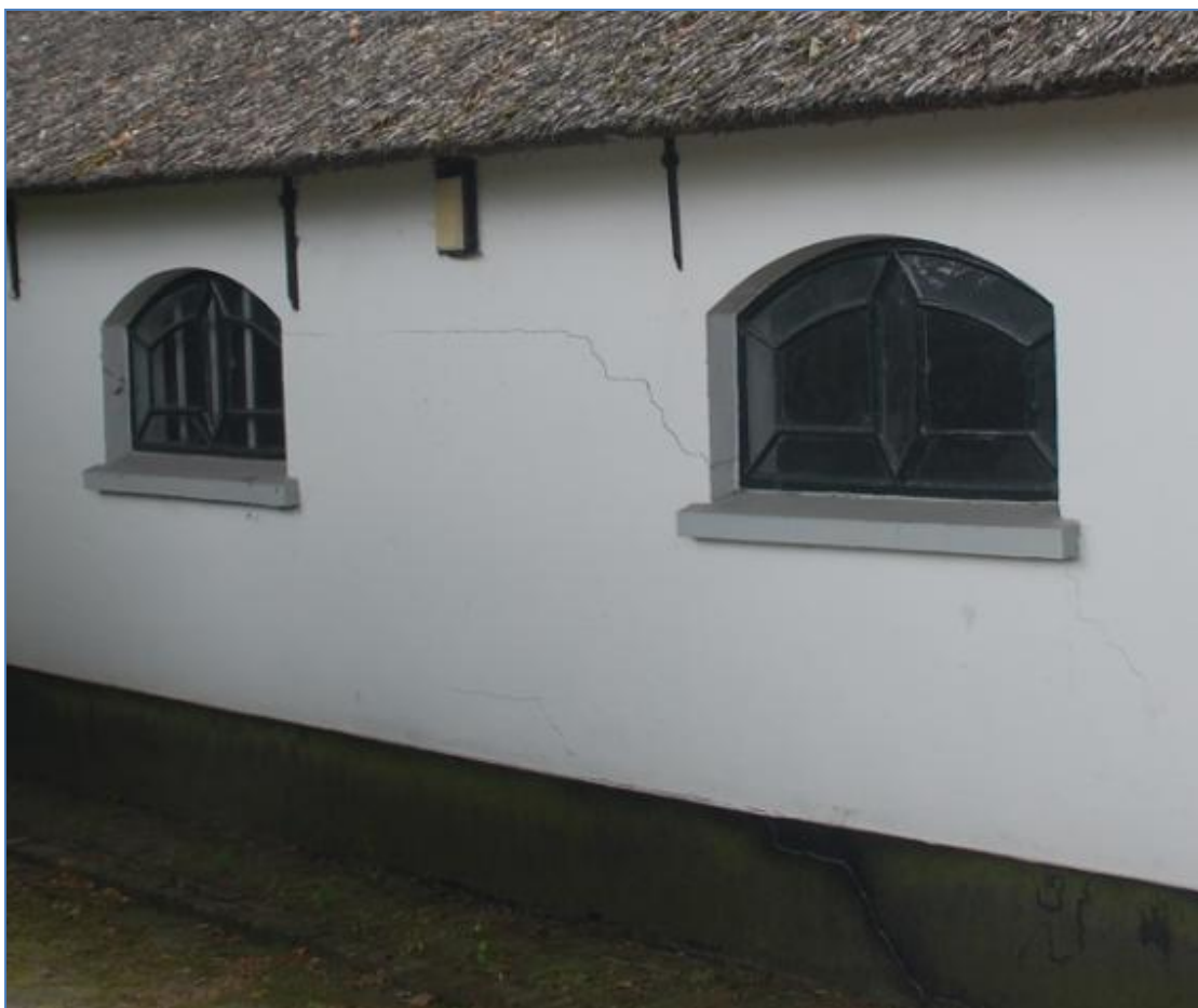
Scheuren in stucwerk
