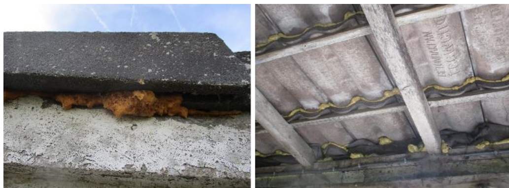
Figuur 2 (Links) De kantpannen zijn afgedicht met pur. (Rechts) Er ontbreekt aan dakbeschot onder de dakpannen. Hierdoor is het uitgesloten dat er sprake is van vaste rust- en verblijfplaatsen ten aanzien van vleermuizen.
